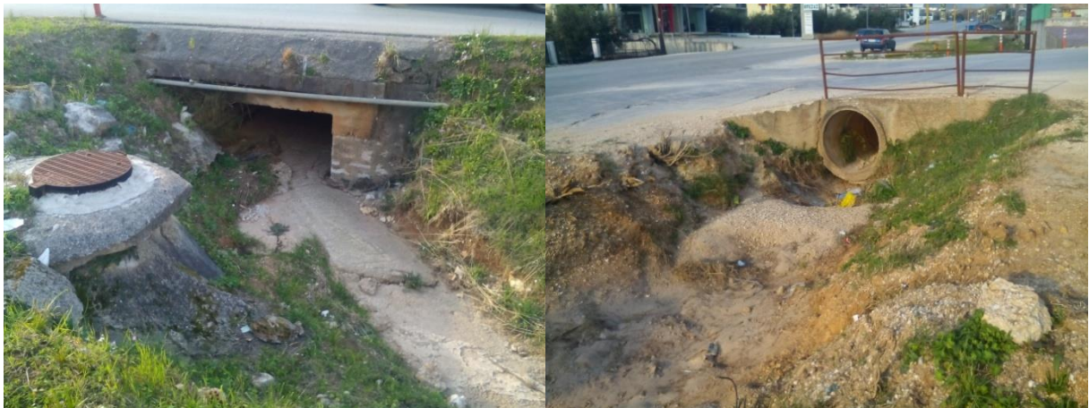
Εικόνα 6-12 Ρέμα Ν. Σελεύκειας – Μαυρουδίου Θρ 11Α: είναι θέση όπου διαπιστώθηκαν πλημμυρικά φαινόμενα, λόγω της συμβολής του ρέματος της Ν. Σελεύκειας με το δευτερεύον ρέμα της Εθνικής Αντίστασης
