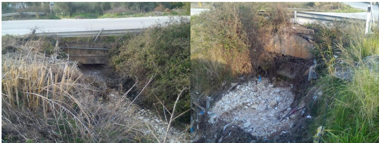
Εικόνα 6-13 Ρέμα Ν. Σελεύκειας – Μαυρουδίου Θρ 11: είναι θέση όπου διαπιστώθηκαν πλημμυρικά φαινόμενα, λόγω της συμβολής του ρέματος της Ν. Σελεύκειας με δευτερεύον ρέμα του οικισμού Εθνική Αντίσταση, πολλά φερτά υλικά
