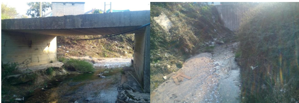
Εικόνα 6-14 Ρέμα Ν. Σελεύκειας – Μαυρουδίου Θρ 11B: είναι θέση όπου διαπιστώθηκαν πλημμυρικά φαινόμενα, λόγω της συμβολής του ρέματος της Ν. Σελεύκειας με δευτερεύοντα ρέματα του οικισμού Εθνική Αντίσταση, πολλά προβλήματα στις γειτονικές περιοχές
