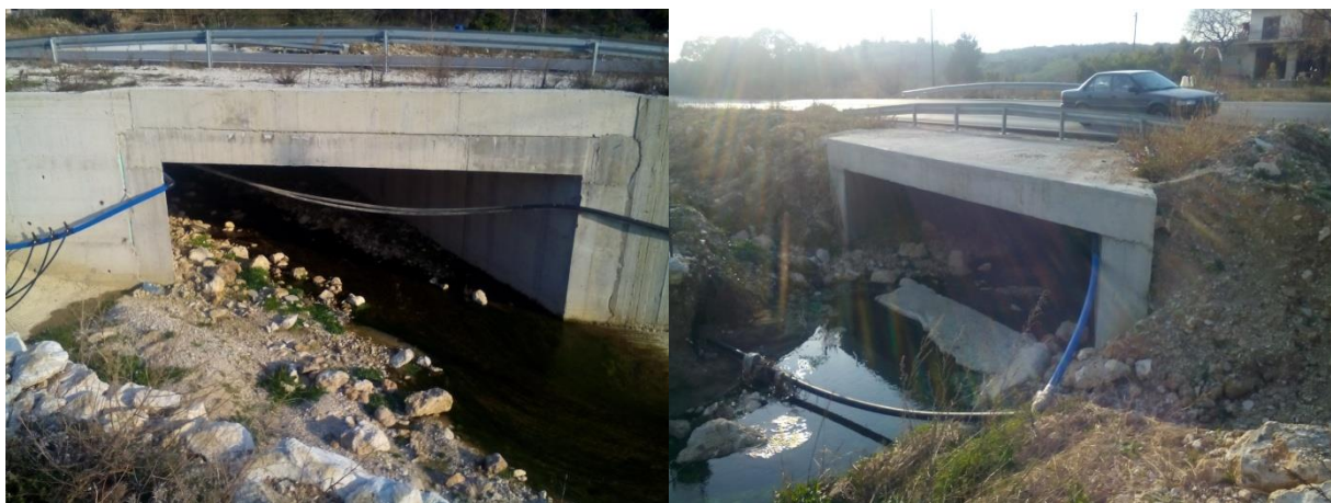
Εικόνα 6-15 Ρέμα Ν. Σελεύκειας – Μαυρουδίου Θρ 12: θέση όπου συγκεντρώνονται, το ρέμα του Μαυρουδίου (κλάδος του μεγάλου ρέματος) και ρέματα του οικισμού Εθνική Αντίσταση. Κατασκευάστηκε νέο τεχνικό έργο.
