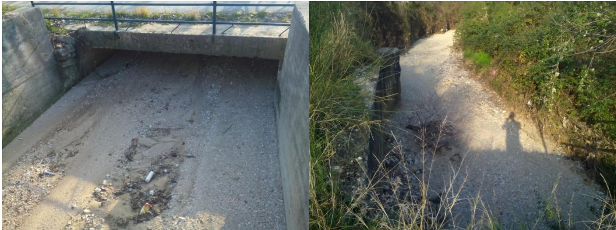
Εικόνα 6-6 Ρέμα Τσιμπουρίκι Θρ 5Α: μεγάλες ποσότητες φερτών υλικών, κατάντη της θέσης 5
