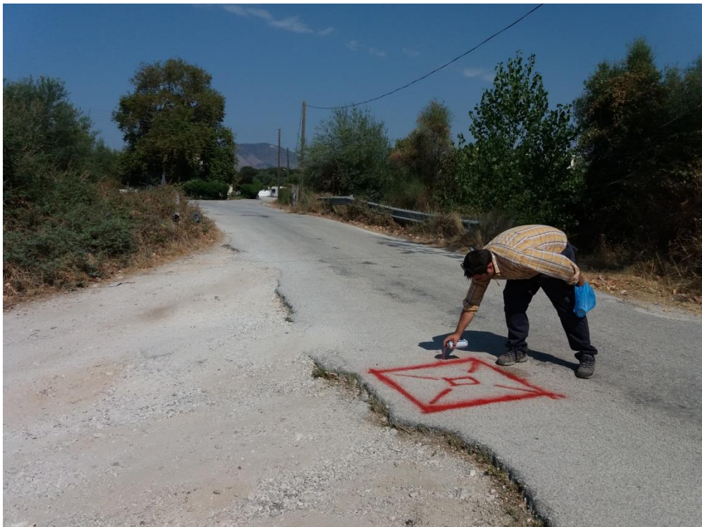
Φωτοσταθερά πλησίον του ρέματος Τσιμπουρίκι
